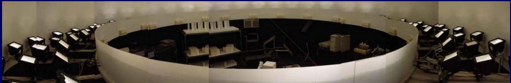
인공천공실 내부에서 설치된 조명기구의 전경
